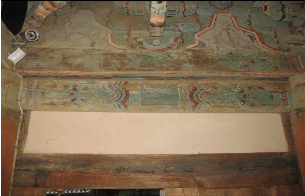
<사진1> 방염제로 인한 습기로 인해 심하게 훼손된 미황사 대웅보전의 내부 모습
