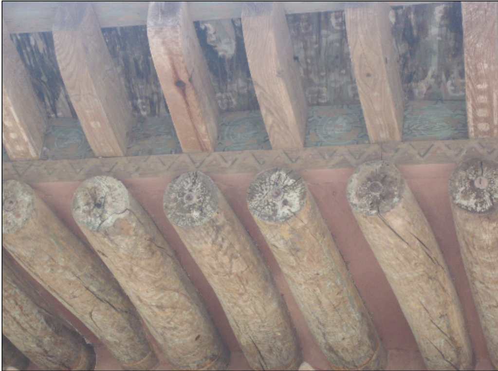
<사진> 잘못된 복원공사로 인해 비가 새어 곳곳이 시커멓게 썩은 선암사 대웅전의 모습
