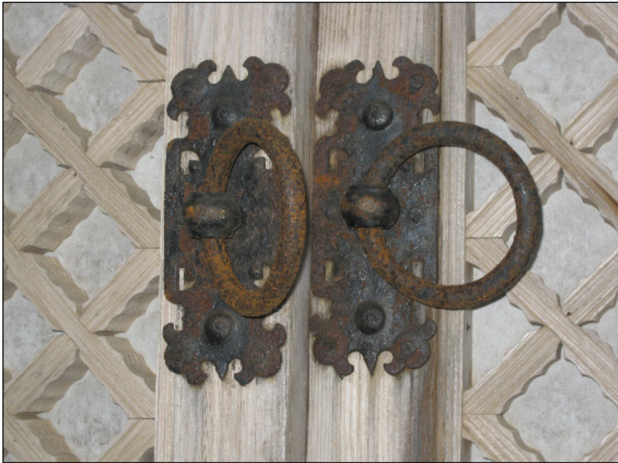
<사진> 방염제로 인해 미황사 대웅보전의 문고리가 심하게 부식된 모습
