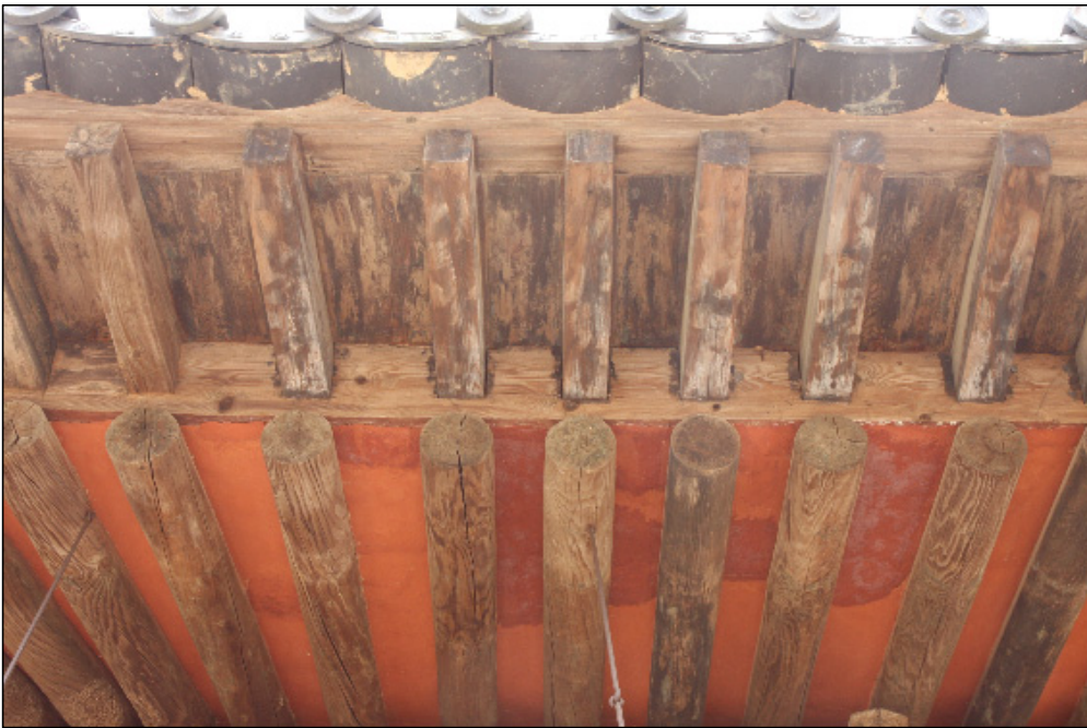
<사진2> 방염제로 인해 훼손됐을 것으로 추정되는 무량수전 처마의 모습 2
