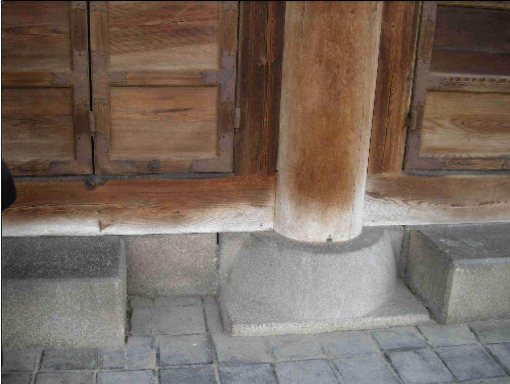
<사진> 심한 백화현상으로 보이는 현상이 발생한 화성행궁 화령전의 기둥모습
