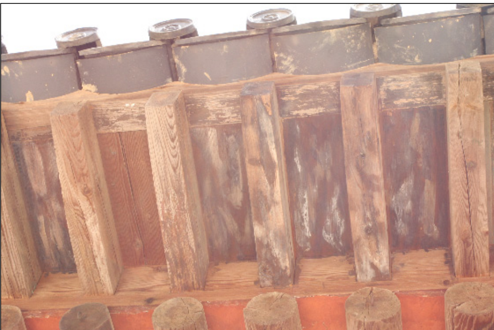
<사진3> 방염제로 인해 훼손됐을 것으로 추정되는 무량수전 처마의 모습 3
