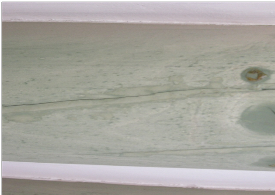
<사진2> 얼룩현상이 발생한 화성행궁 단청의 세부 모습 2
