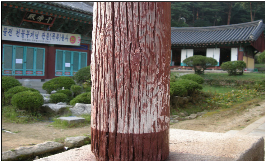
<사진1> 방염제로 인한 훼손 가능성이 엿보이는 용주사 대응보전의 기둥
