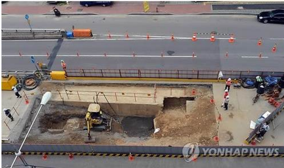
(서울=연합뉴스) 김도훈 기자 = 14일 오전 서울 송파구 석촌지하차도 도로 함몰 사고 현장에서 기자 및 관계자들이 현장을 둘러보고 있다.
