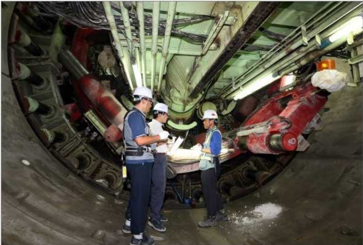
국토부, 전국 대형 굴착공사현장 안전점검, 최근 싱크홀과 공동 등이 잇달아 발견돼 안전사고에 대한 우려가 커지는 가운데 20일 오후 서울 송파구 방이사거리 인근 지하철 9호선 920공구 현장에서 국토교통부와 한국시설안전공단 등 관계자들이 터널 굴착 장비인 실드 TBM(Shield Tunnel Boring Machine)을 점검하고 있다. 연합뉴스
